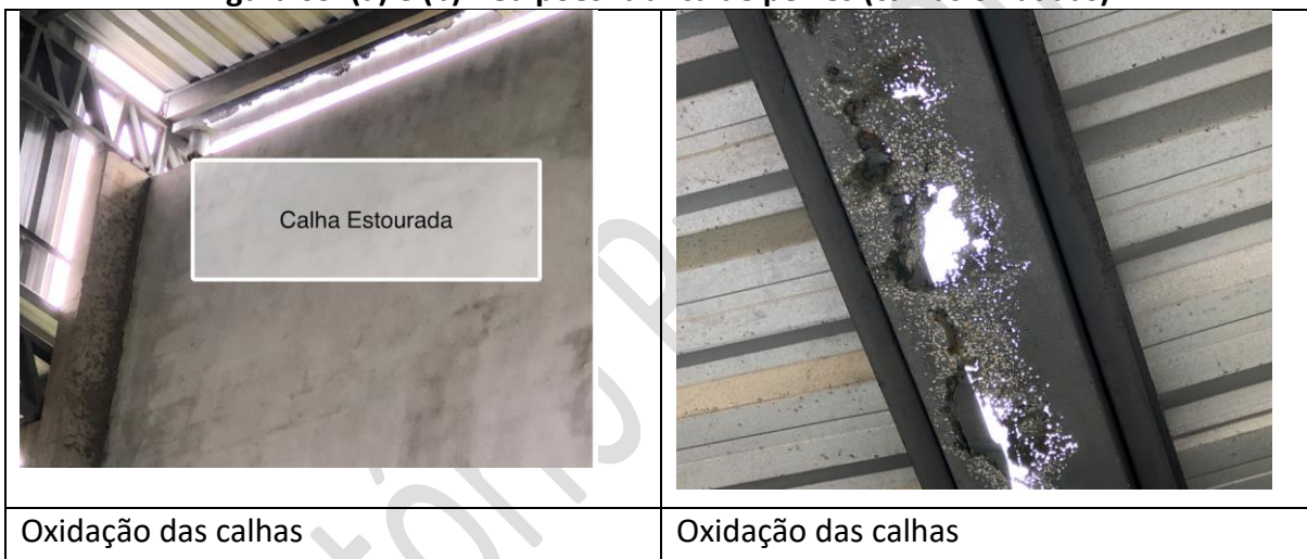
Figura 03 (a) e (b)– Galpões fábrica de peixes (calhas oxidadas).
