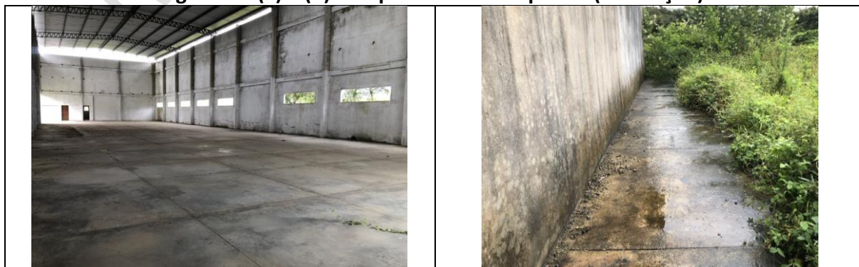
Galpões com infiltrações em pisos e paredes
